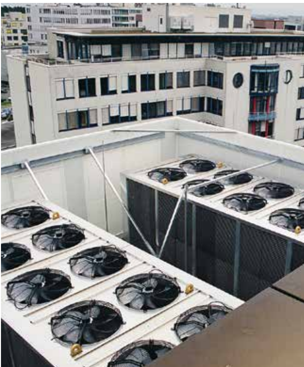
Bullerdämpning av kylmedelskylare, Stuttgart, Tyskland.
