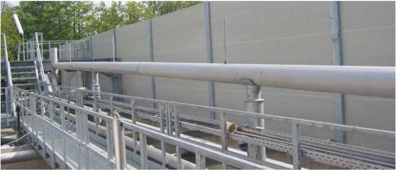
Bullerskärm vid kemianläggning Luneville, Frankrike.
