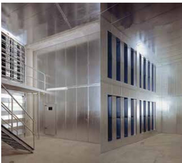
Ljutfälla fläktrum Kista Entre, Stockholm.
